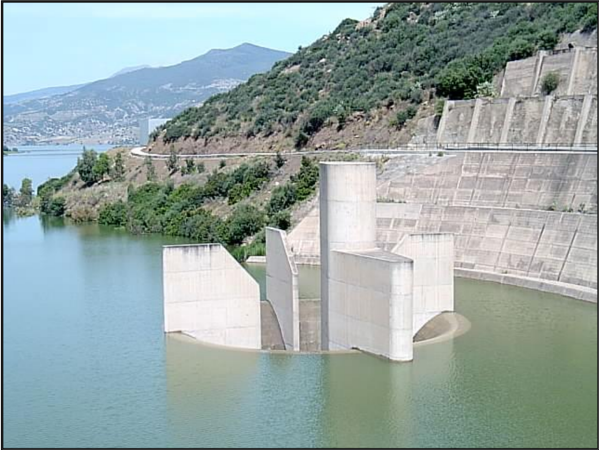
Figure 2-4 : Le barrage Hammam Debagh : évacuateur de crues de type Corolle et Seuil libre (source : ANBT, 2010)
