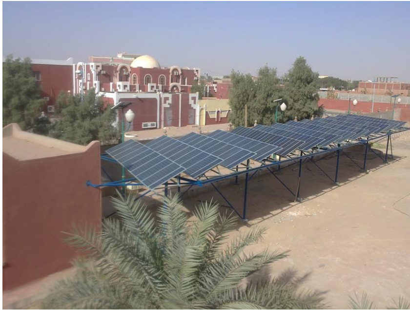
Fig. 2.9. parking solaire réalisé au niveau de l'URER-MS Adrar [46].
