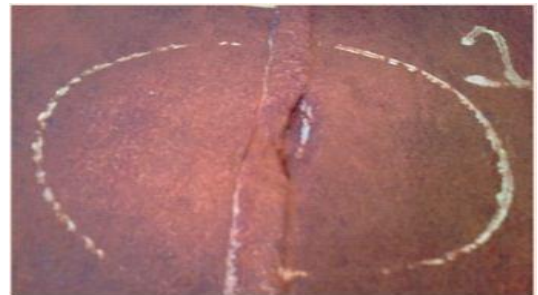
Figure 1-f : Corrosion en cordon de soudure
