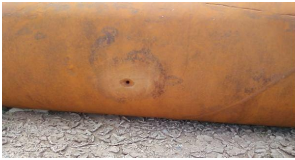
Figure 1-a : Corrosion externe par piqure
