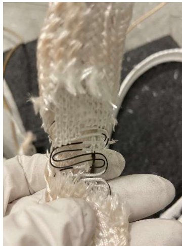
Figure 3. 18 Rubans chauffants dénudés.
