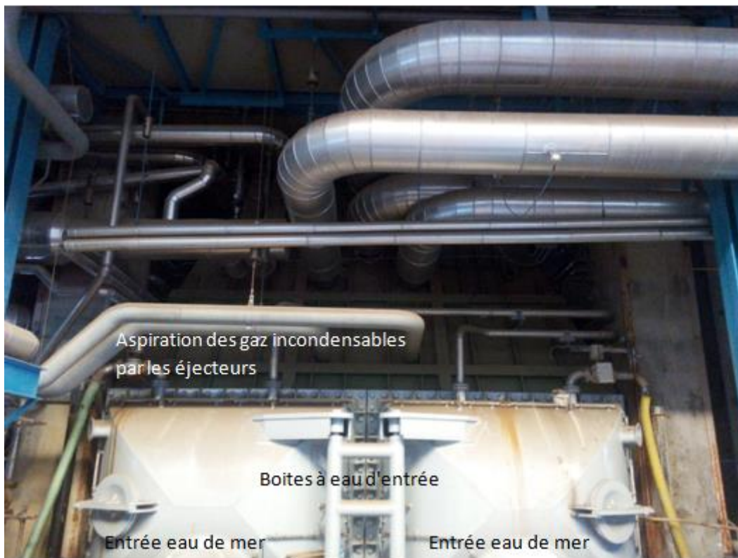
Figure V.1: Boîtes à eau d'entrée
