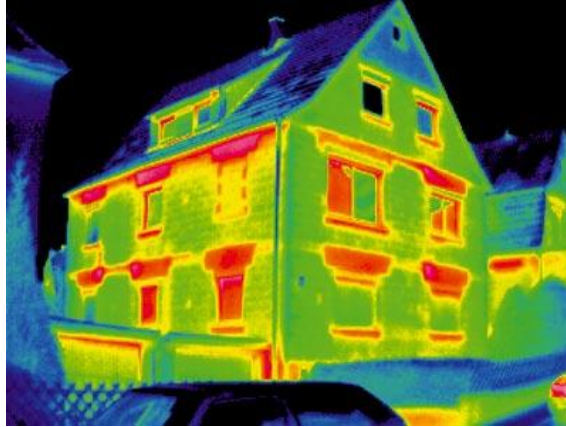
FIGURE 1.7 – Thermographie d'un logement illustrant les ponts thermiques [19]
