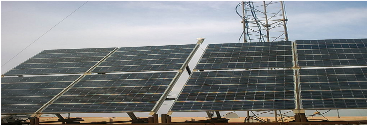
Figure VI.2 : Générateur photovoltaïque UDTS 50
