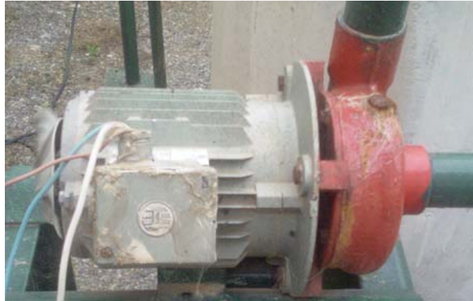
Figure VI.5 : Moteur asynchrone couplé avec une pompe Mitidja 36
