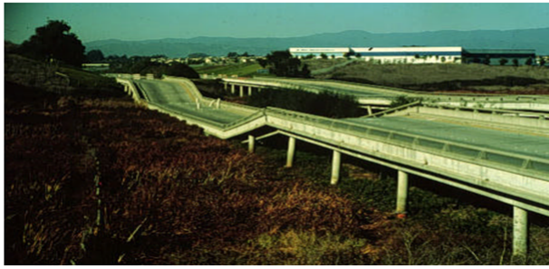
(a) Rupture du pont après la liquéfaction.
