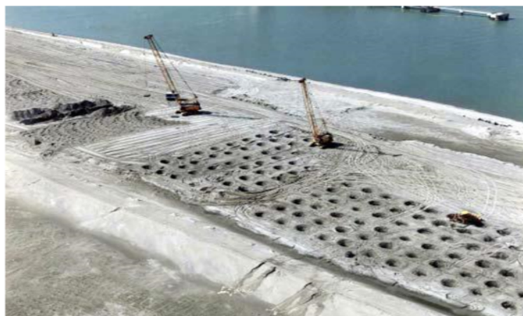
FIGURE 2.3: Vue aérienne du site subissant une amélioration des sols par compactage dynamique.[4]
