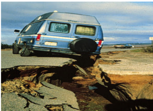
(a) Rupture routière induite par la liquéfaction
