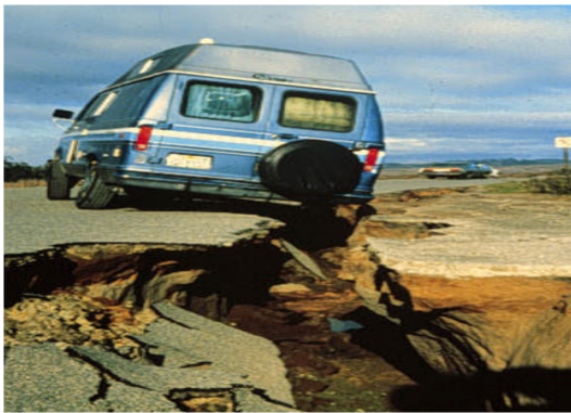
(a) Rupture routière induite par la liquéfaction
