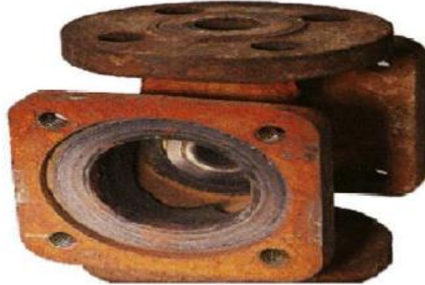
Figure 3.4 Corrosion générale (rouille) d'une pièce en acier [89]
