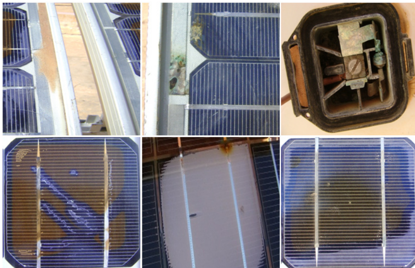
Figure III.10: Les défauts visibles sur les modules.
