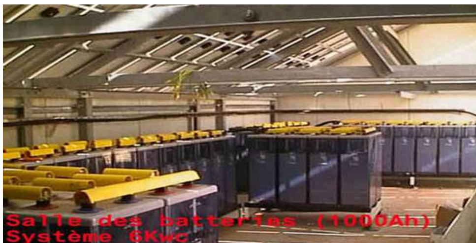
Figure 2.4. Salle de batteries de capacité 1000Ah du système PV installé au village de Gara Djebilet à la Wilaya de Tindouf mis en service au 19/07/1999.
