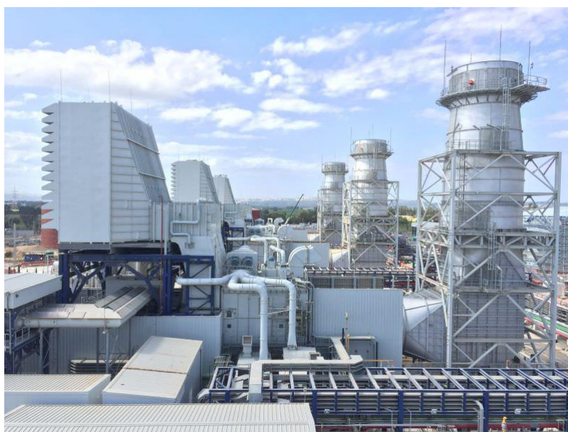
FIGURE 1.7 – Les 3 groupes turbo-alternateurs présents dans la centrale électrique de Boufarik II.
