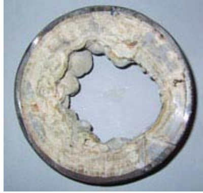
Figure 1.1 : Formation du calcaire sur la paroi interne de la conduite (diminution du diamètre interne).
