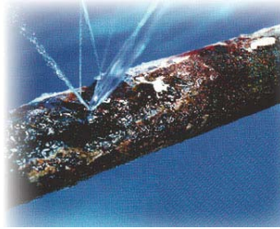
Figure 1.3 : Fuite d'eau due à une corrosion externe de la conduite.
