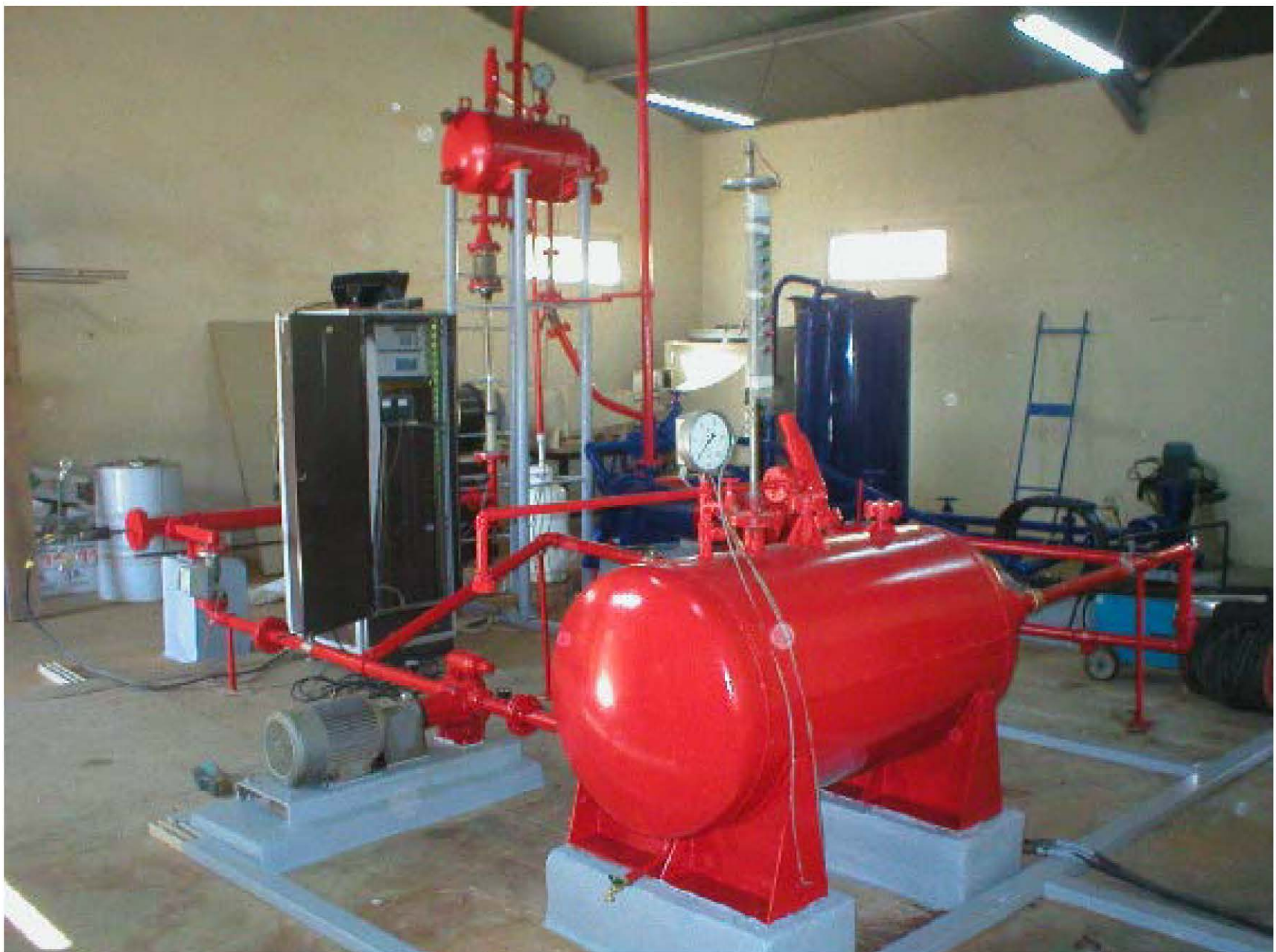
Fig. A4.1 : Photographie de l'installation
