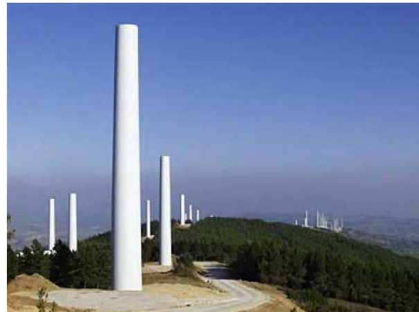
Fig. I.13. Pylône tubulaire d'un futur parc éolien [29].
