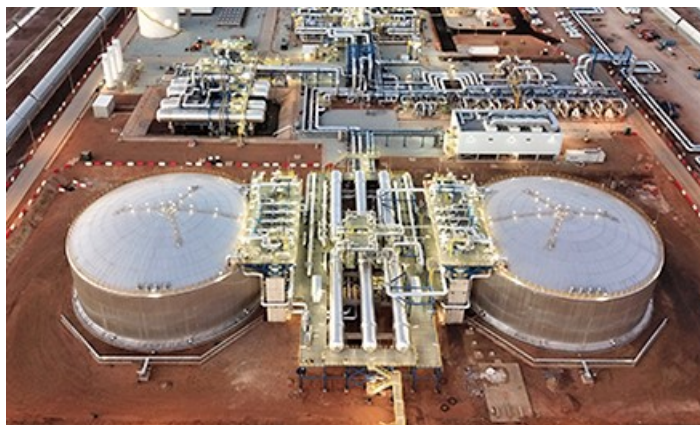
Figure 2.4: Deux Réservoirs de stockage thermique
