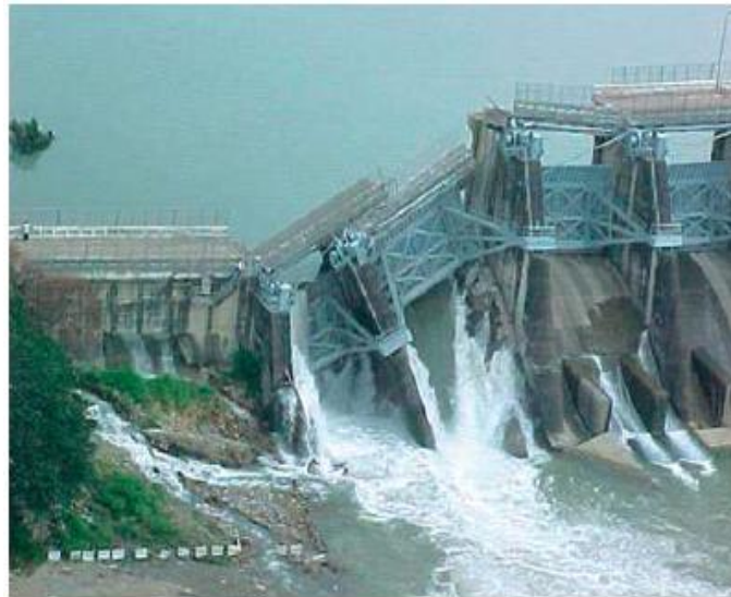
Fig.II.11 : Rupture du barrage ShiKang. [RAP]
