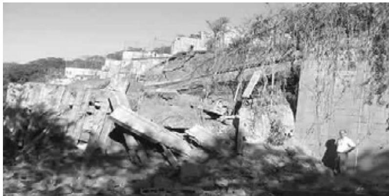
Figure. 0.3 Les ruines d'un mur de soutènement, Nigata2004, (Yazdani et Azad, 2007).
