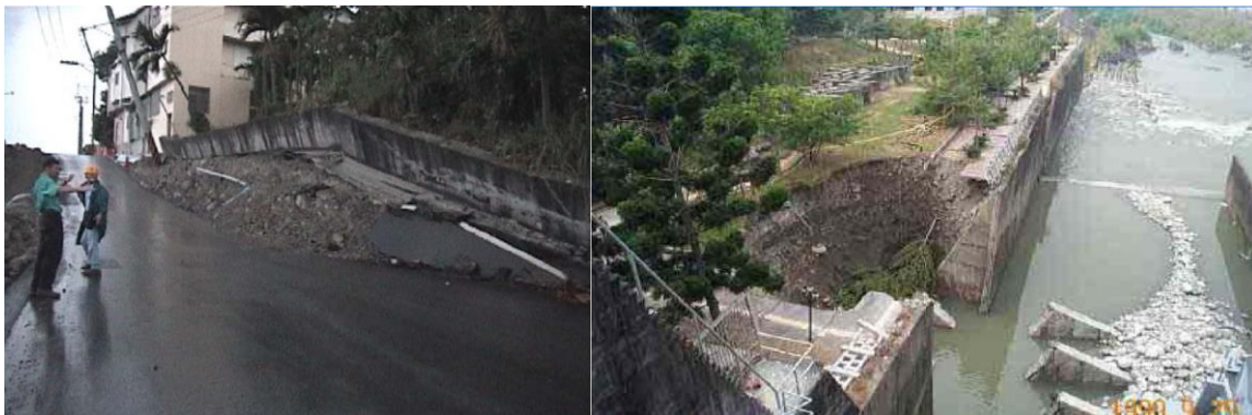
Figure. 0.4 Les ruines des murs de soutènement, séisme de Chi-Chi Taiwan, (Pathmanathan, 2006).
