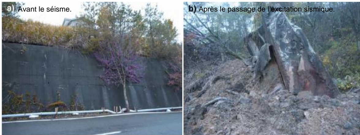
Figure. 0.2 Mur de soutènement avant et après l'effondrement par le séisme de Nigata-2004, (Trandafir et al, 2007).
