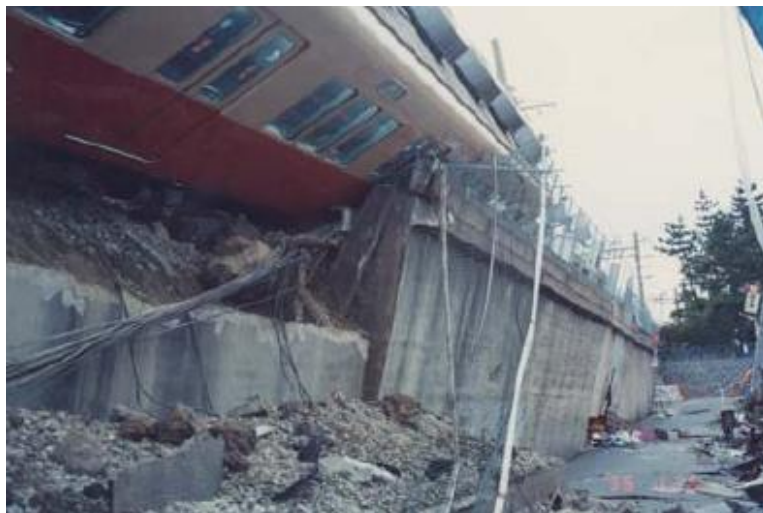
Figure. 0.1 Effondrement d'un mur de soutènement endommagé par le séisme de Kobe-1995.
