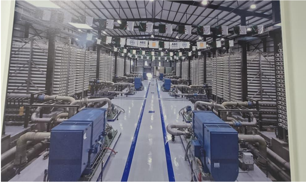
Figure II.10 : L'unité d'osmose inverse (photo originale).
