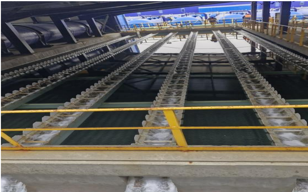
Figure II.7 : Décanteurs Lamellaires (photo originale).
