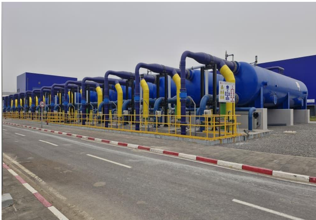
Figure II.8 : Filtres à sable (photo originale).
