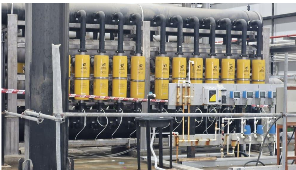
Figure II.11 : Système de récupération d'énergie (photo originale).
