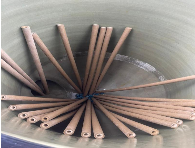
Figure III.11 : Phénomène d'arrachement des cartouches du filtre FC 06 (photo originale).
