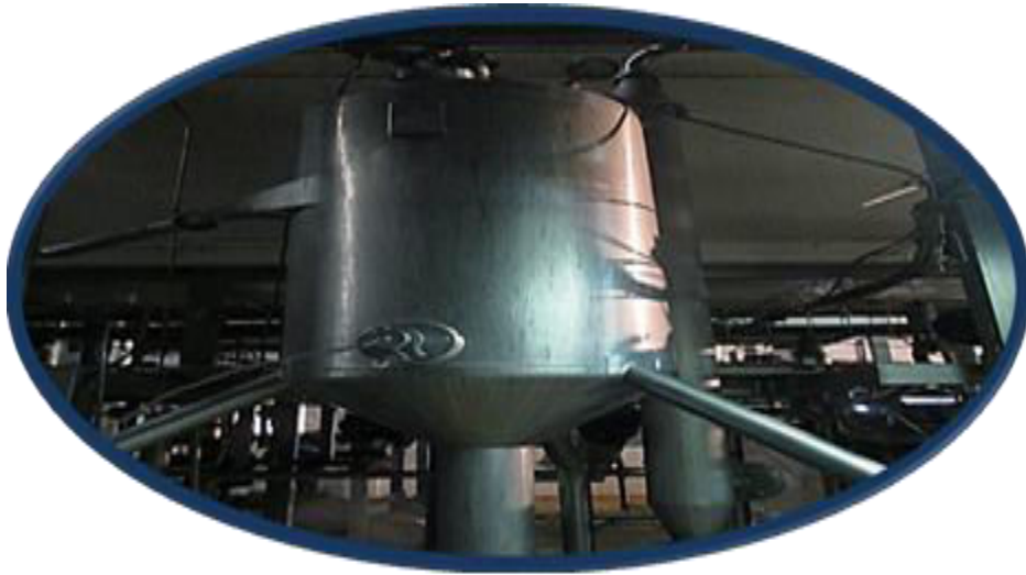
Figure 1.13 : La cuve de dégazage (photo réelle)
