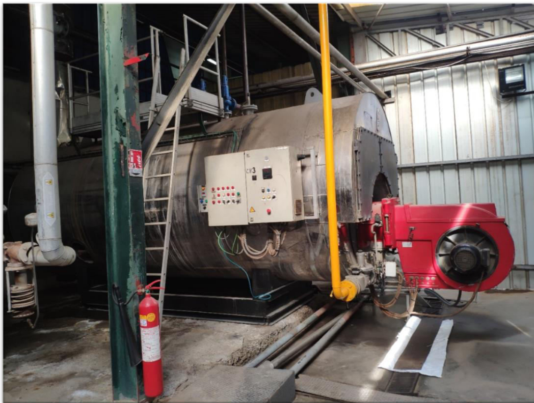
Figure 4.2 : La chaudière active dans le locale des chaudières (photo réelle)
