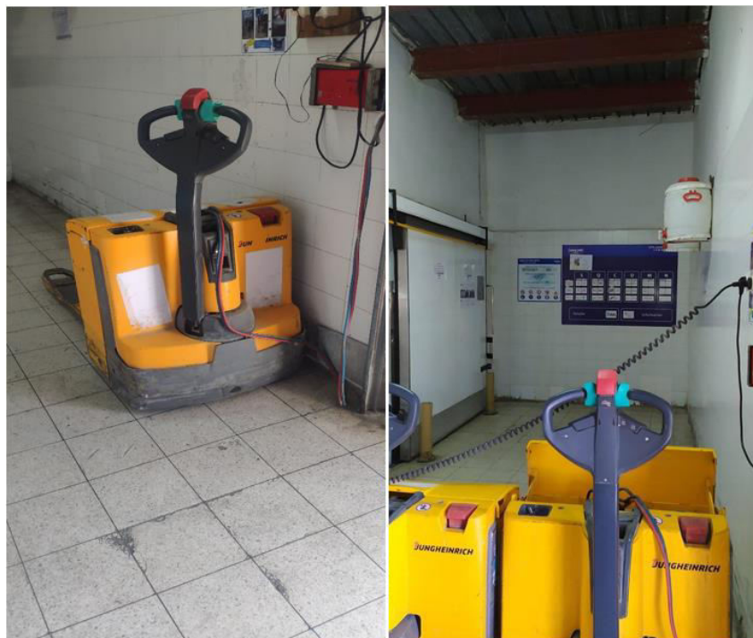
Figure 4.10 : Local de chargement des batteries (photo réelle)
