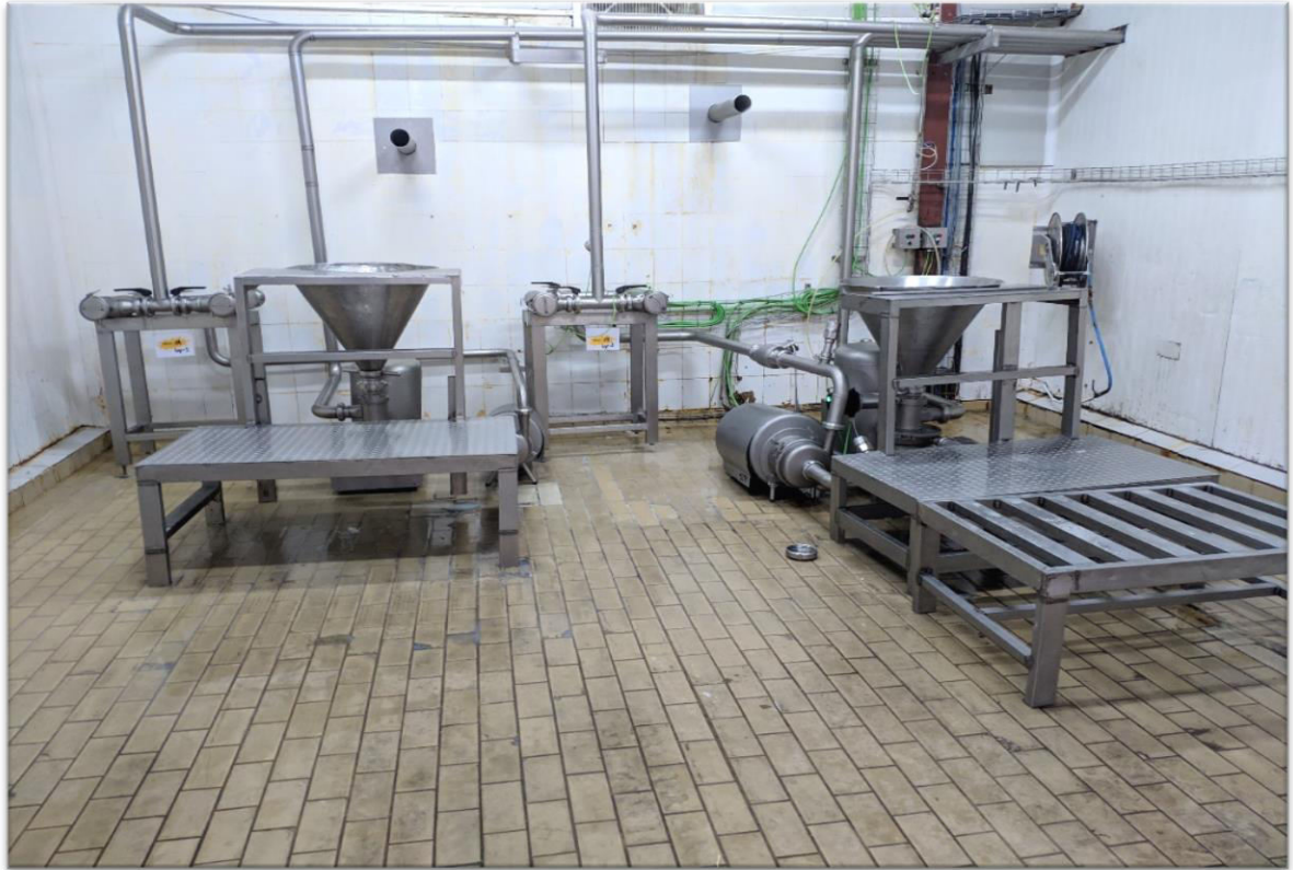
Figure 4.17 : Atelier de poudrage (photo réelle)
