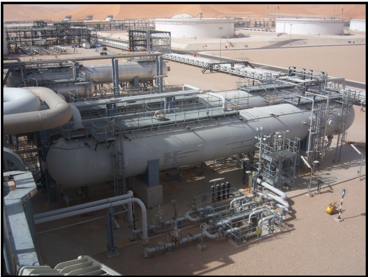
Figure 5: Séparateur primaire : slug catcher de l'installation EL MERK
