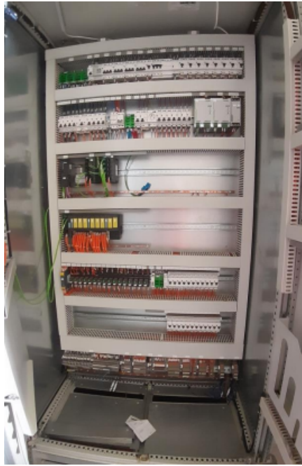
FIGURE II.2 – Armoire automate de désenfumage, de la station.
