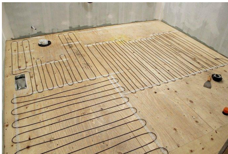
Figure 1.13: Plancher chauffant électrique
