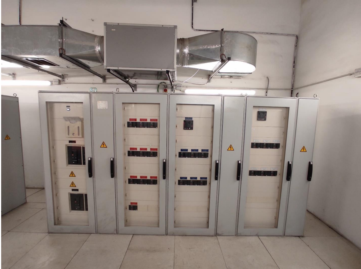
Figure III.2 Les cellules du Poste Eclairage Force
