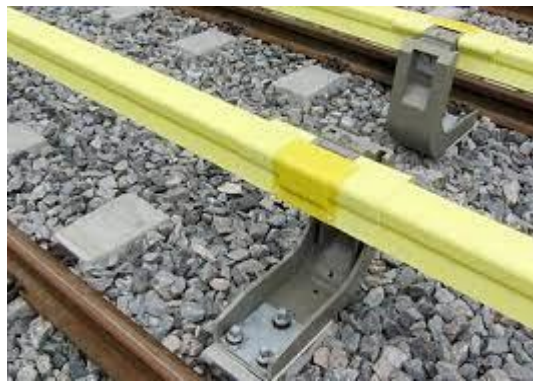
Figure II.2 Le troisième rail
