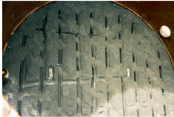
Figure V.8 : Grille d'anodes de protection de type ruban [12]
