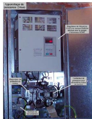
Figure III. 11 : armoire de commande pour ascenseur (drive).
