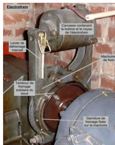
Figure III. 10 : frein mécanique de l'ascenseur.
