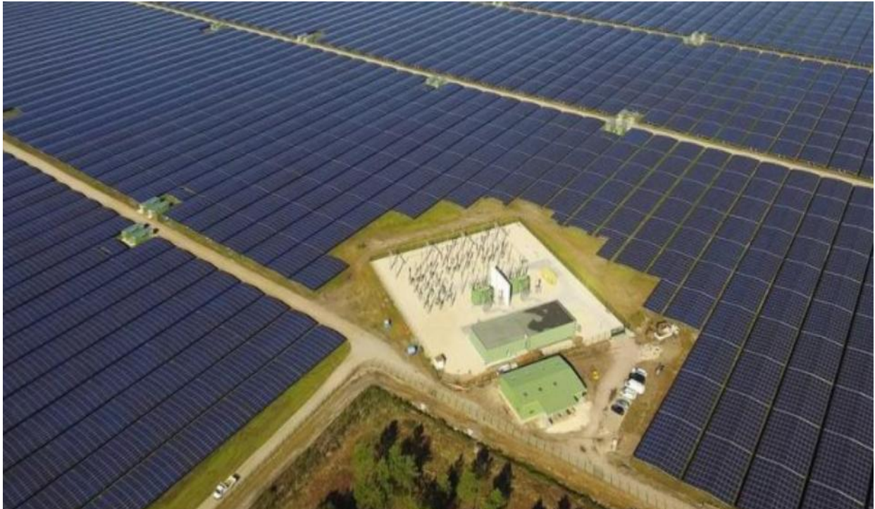
Figure 4-1:La centrale solaire de Cestas (Gironde) édifée sur 300 ha
