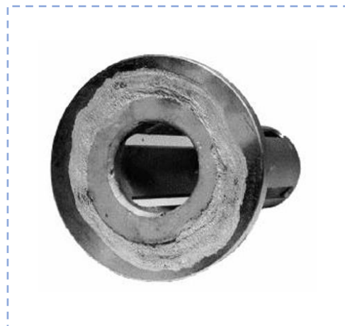
Figure II. 5 : Corrosion par crevasse
