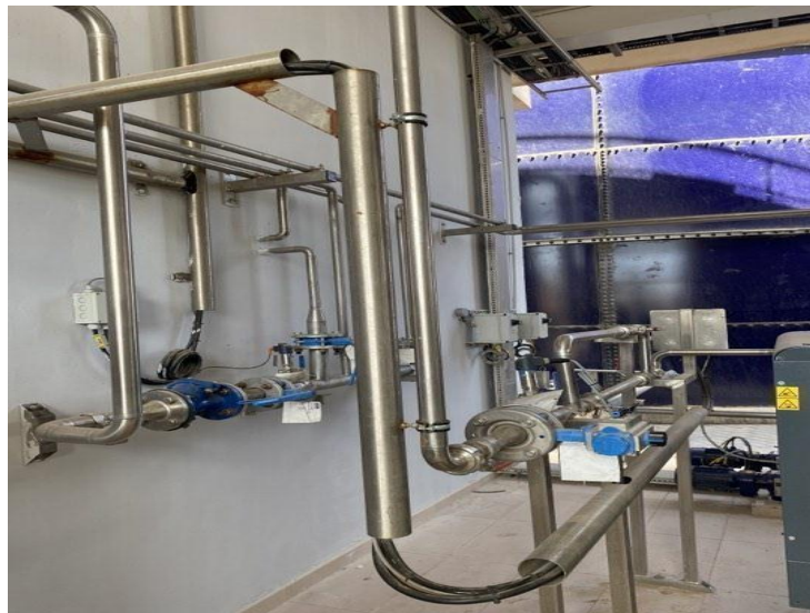
Figure IV.4.les pompes de dosage de la soude et l'acide sulfurique
