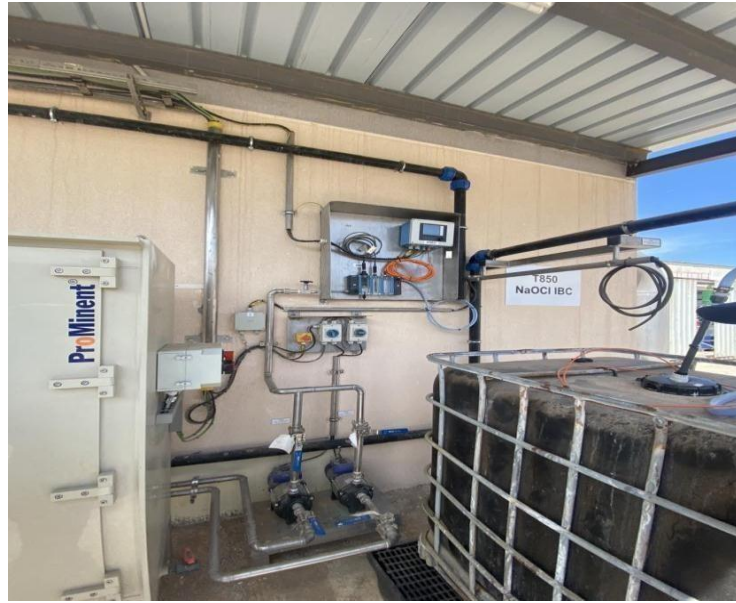
Figure IV.9. Bassin de chloration
