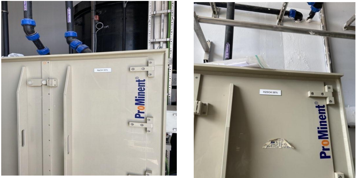
Figure IV.3.les armoires de dosages de la soude et l'acide sulfurique
