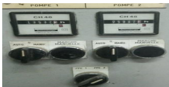
Figure4.3 Partie du tableau de commande d'un bassin à deux pompes
