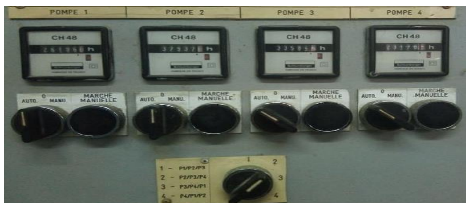
Figure 4.9 Partie du tableau de commande d'un bassin à quatre pompes
