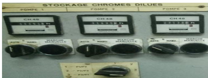
Figure 4.6 Partie du tableau de commande de bassin « CHROMES DILUES »
