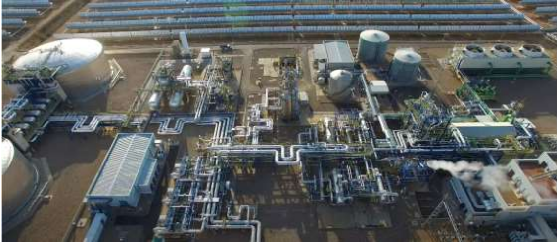
Figure II-16 : Bloc de génération
