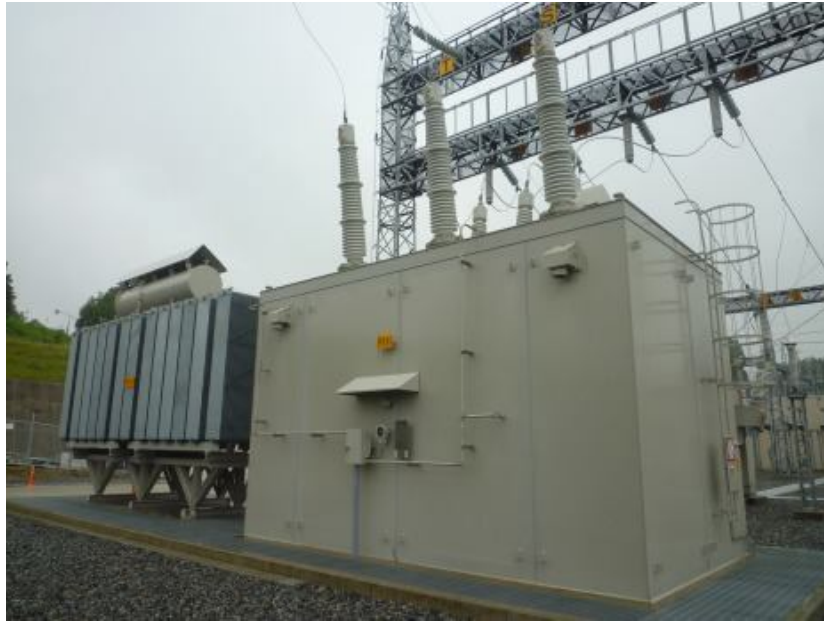
Fig.1.12 Transformateur de Scott 70 MVA Pour l'alimentation d'un train Shinkansen (train à grande vitesse) [158].
