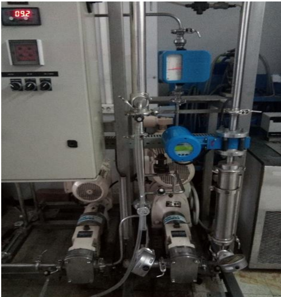
Figure 19 : Dispositif pilote d'ultrafiltration.
