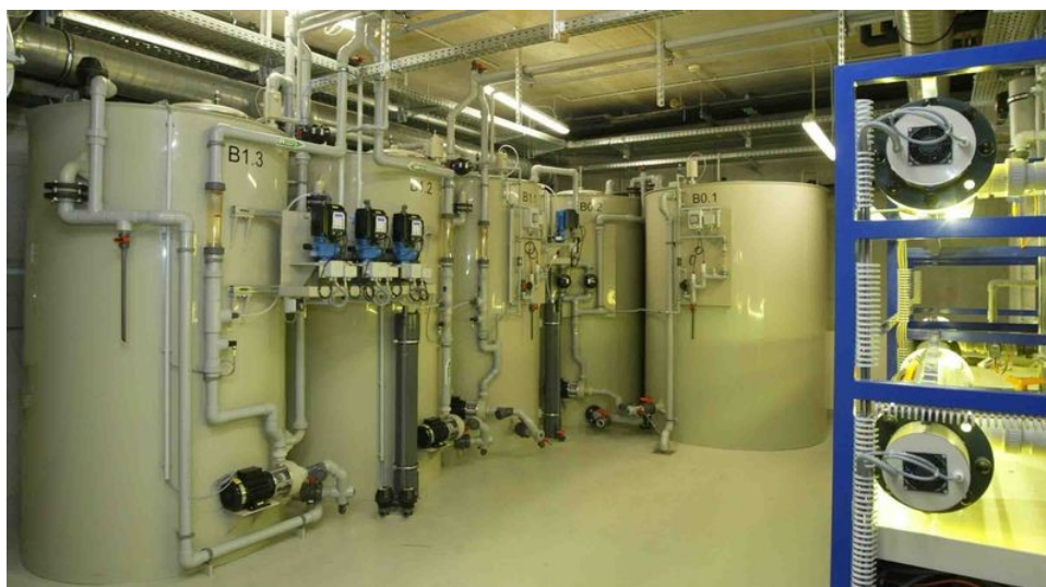
Figure 3.3: Installation Industrielle du procédé Photo-Fenton [70]
