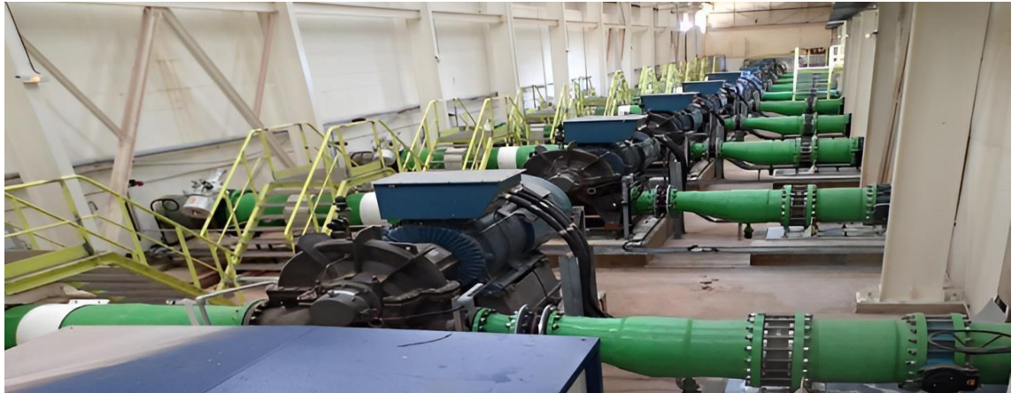
Figure I.8 : photo prise dans la station de dessalement illustrant les pompes HP intermédiaires
