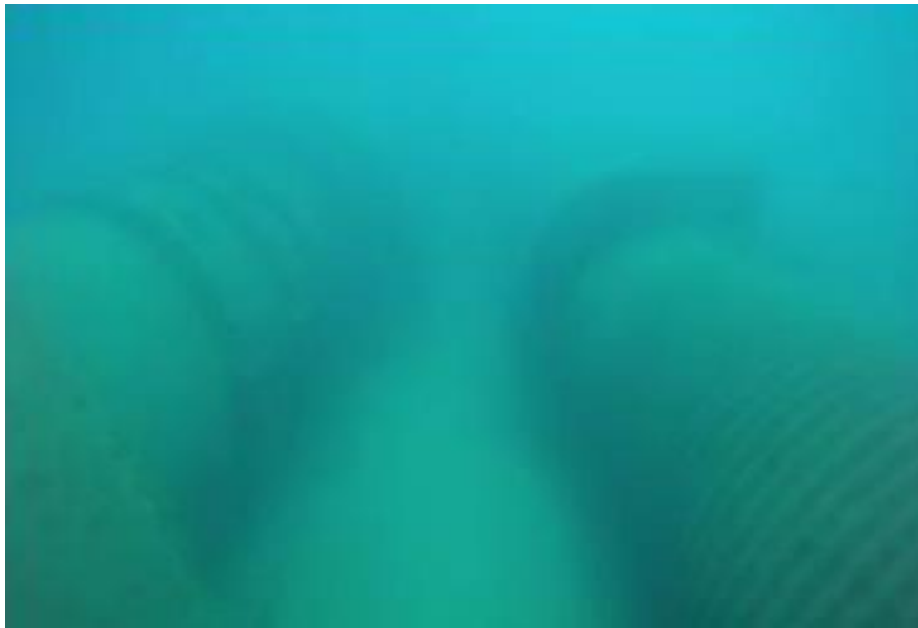
Figure I.5: Photo sous-marine des conduites de captage en PRFV
