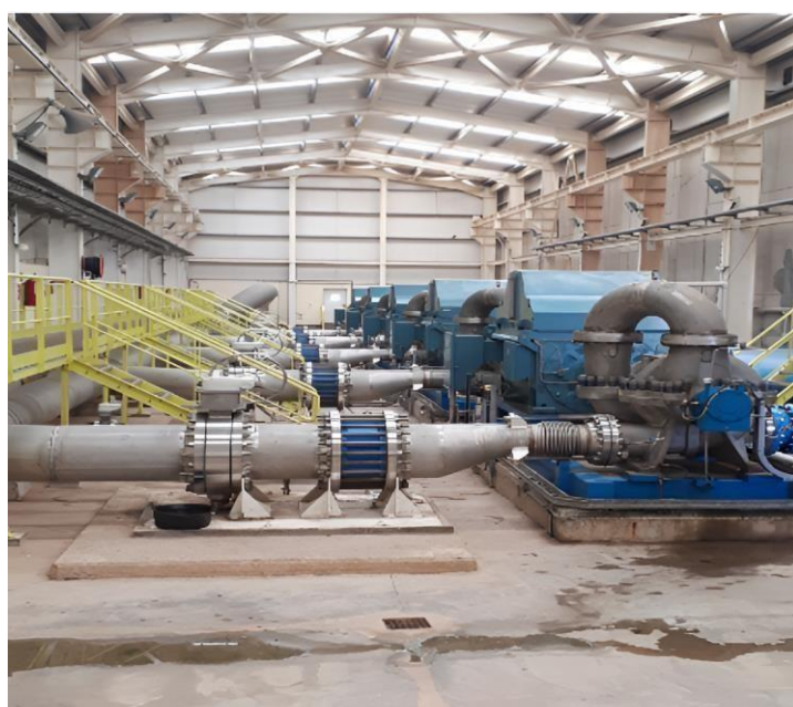
Figure I.14 : photo prise dans la station de dessalement illustrant les pompes HP pour la distribution de l'eau produite
