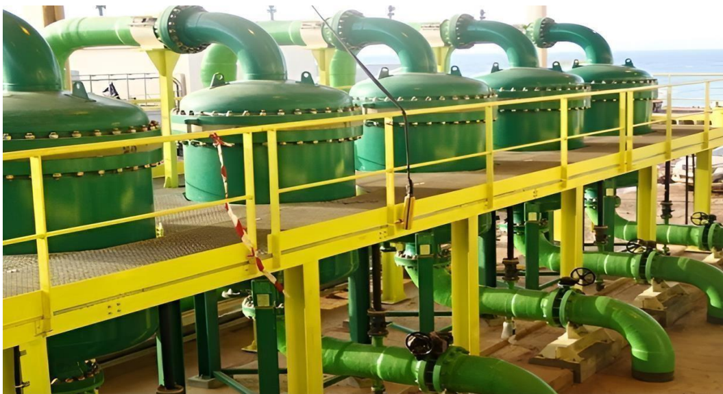
Figure I.9 : photo prise dans la station de dessalement illustrant les filtres à cartouches
