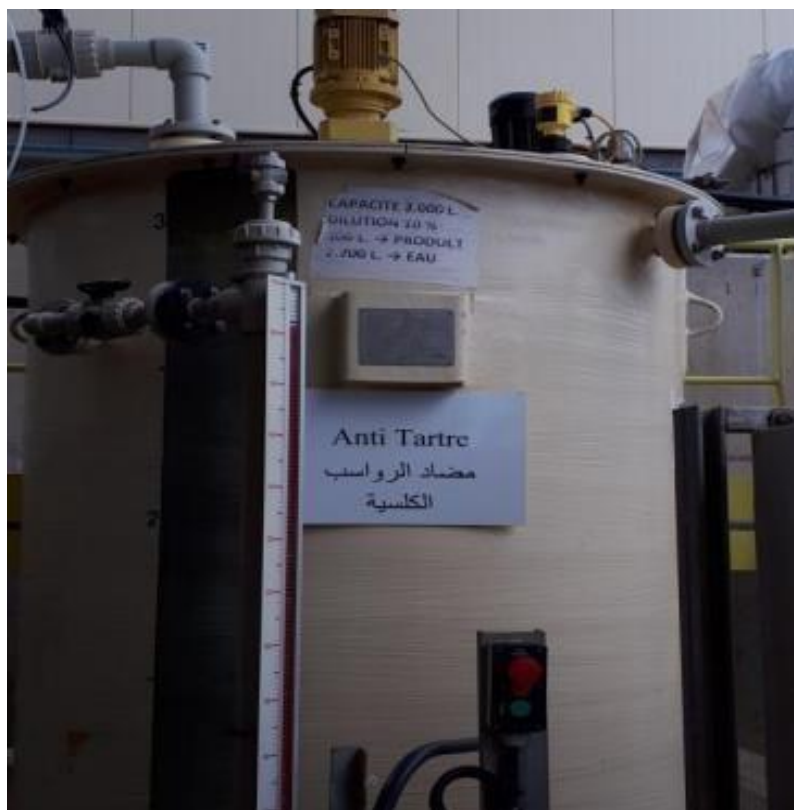
Figure I.10 : photo prise dans la station de dessalement illustrant les cuves de dosage de l'antitartre (Métabisulfite)
