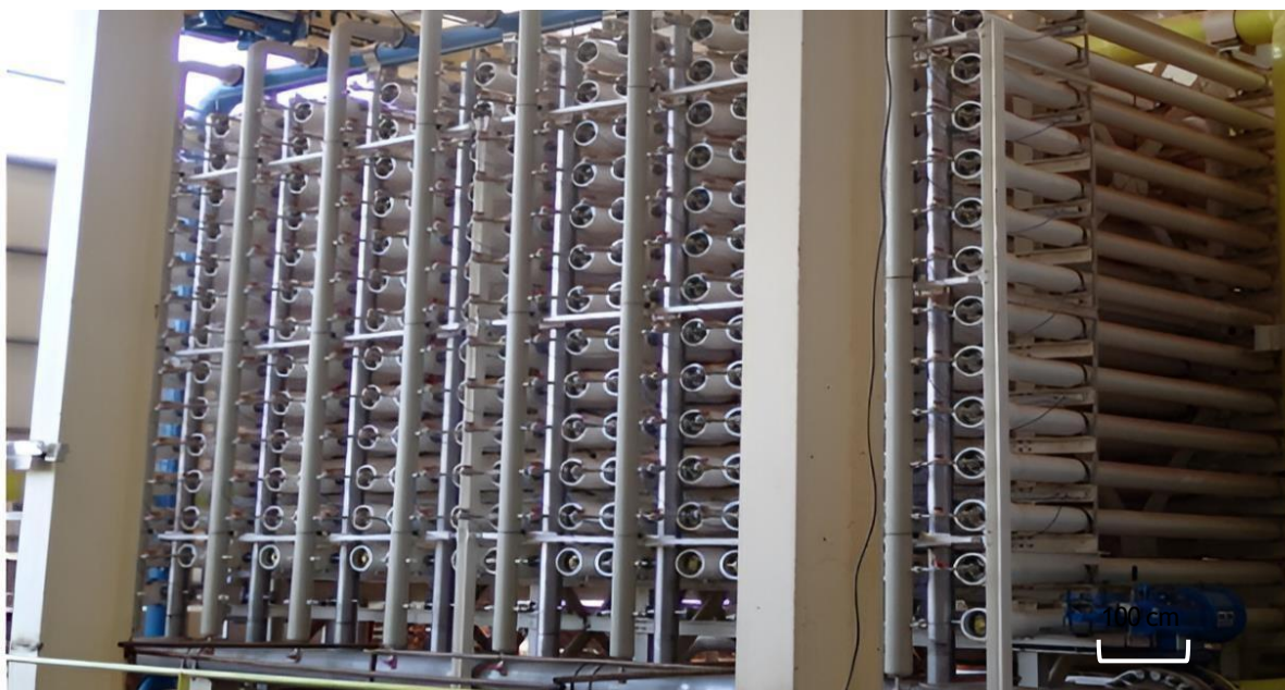
Figure I.11 : photo prise dans la station de dessalement illustrant le rack d'osmose inverse
