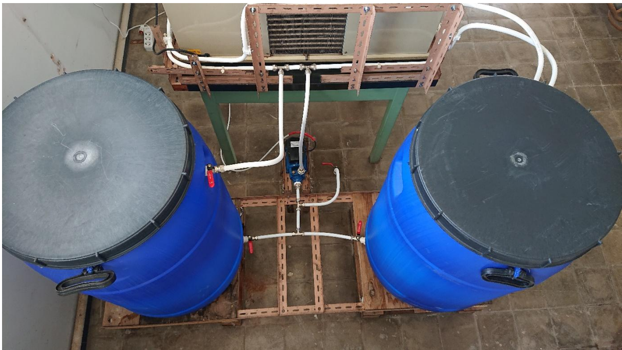
Figure 3.20 : Partie externe du réseau hydraulique réalisé sur le banc d'essais de la PAC HILTON R830
