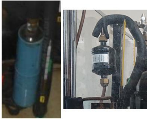
Figure 2.2 : Bouteille de liquide d'origine de la pompe à chaleur HILTON R830 (à gauche) et filtre désormais en fonctionnement sur l'installation (à droite)
