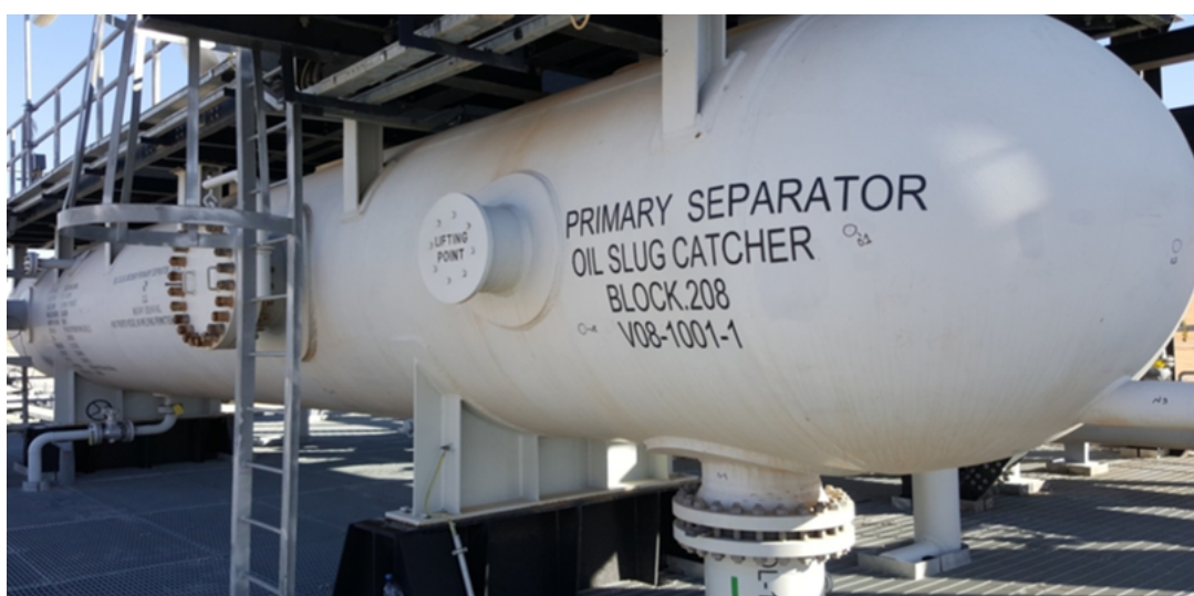
FIGURE 1.8 – Photographie du séparateur V08-1001-1 sur site
