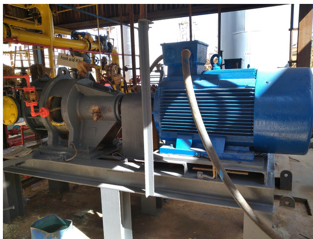
FIGURE 2.4 – Compresseur GARO à anneau liquide
