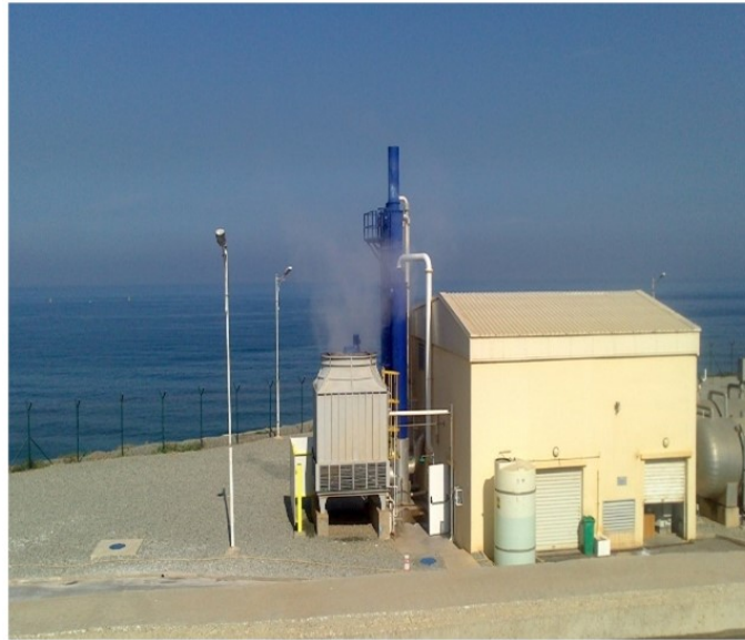
FIG. 3.14: Station de production de CO_2 (Rapport Final de Fouka 1)
