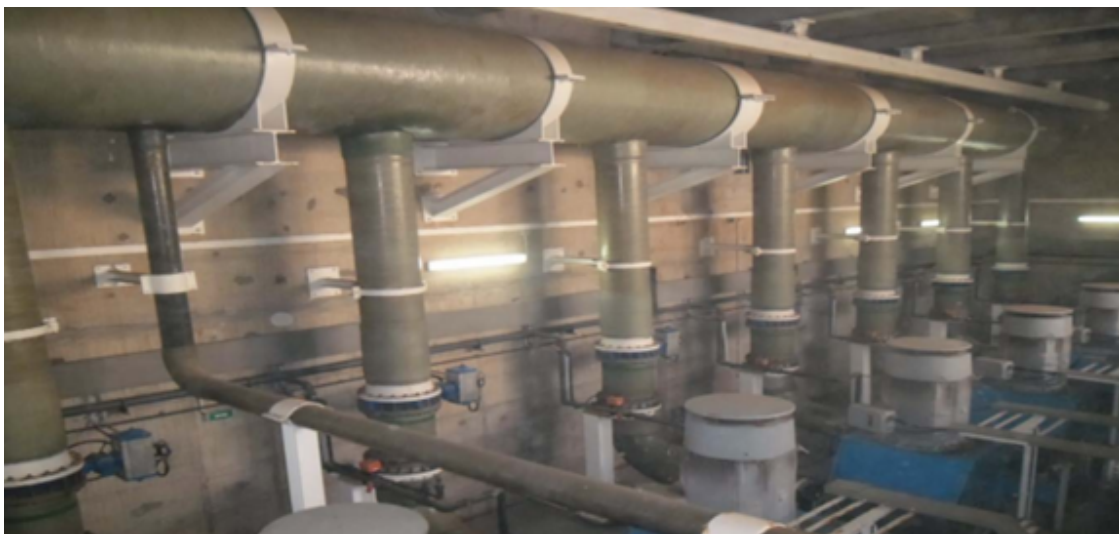
FIG. 3.5: Station de pompage d'eau brute(Rapport Final de Fouka 1)
