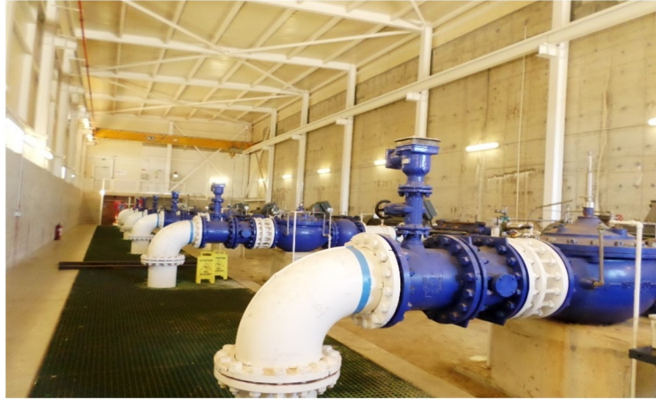
FIG. 3.15: Station de pompage d'eau traité ( Rapport Final de Fouka 1 )
