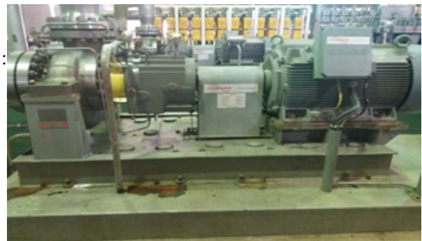
FIG. 3.10: Pompe à haute pression(Rapport Final de Fouka 1)
