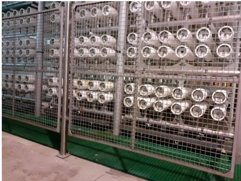
FIG. 3.9: Filière d'osmose inverse(Rapport Final de Fouka 1)
