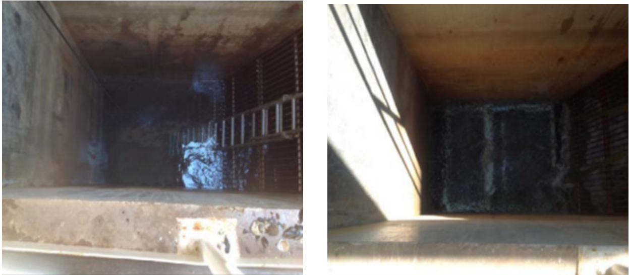
FIG. 3.4: dégrilleur(Rapport Final de Fouka 1)
