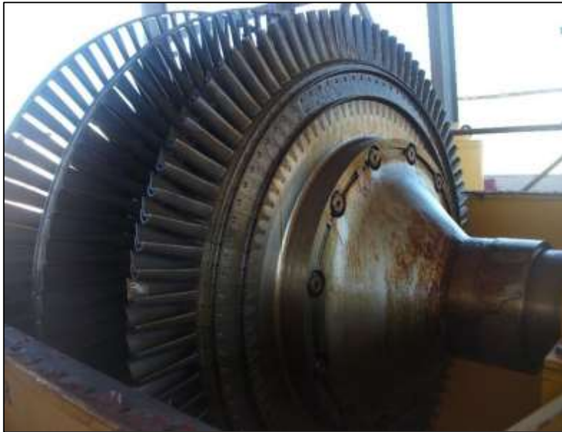
Figure 1.9 : Turbine de détente d'une turbine à gaz
