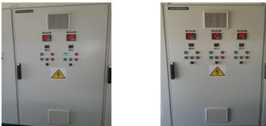
Figure IV-8 Armoire couloir HADJ YAKOUB et DEKAKNA
