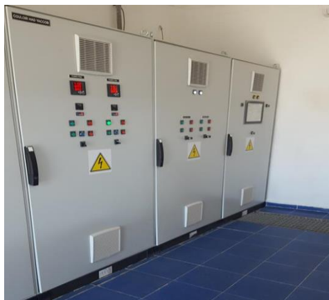
Figure IV-6 Vue de l'armoire TGBT.
