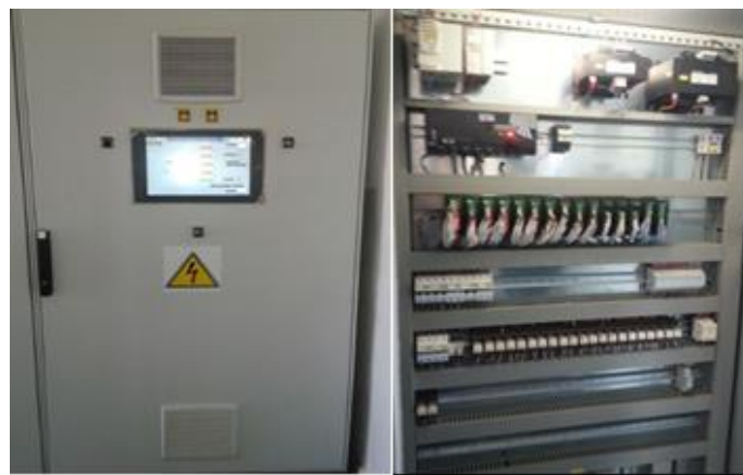
Figure IV-9 vue extérieure et intérieure de l'armoire d'automatisme.
