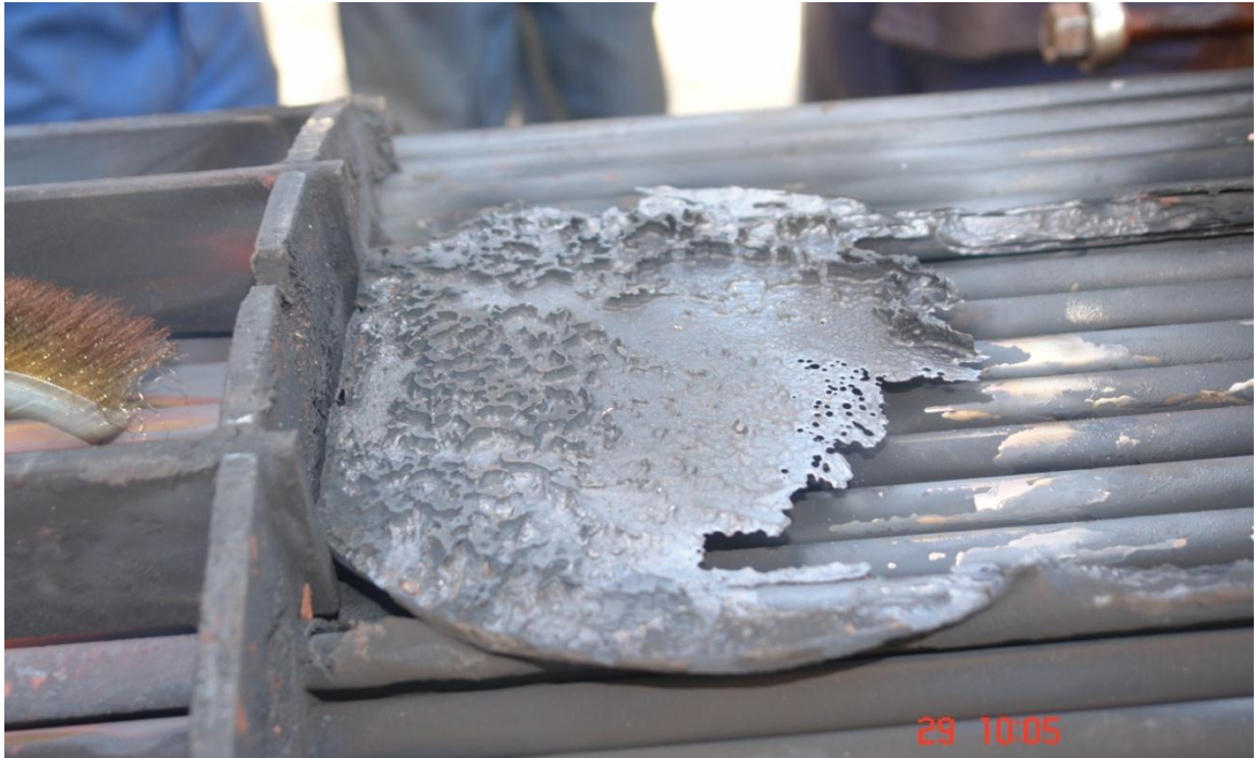
Figure V.4 : Photo montrant la corrosion de la plaque déflectrice 1.
