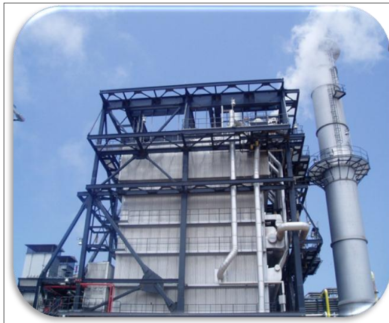
Figure I.2 : Photo montrant la chaudière.
