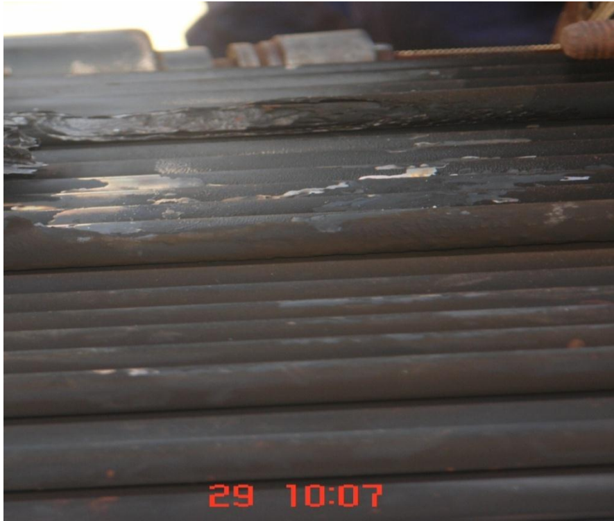
Figure V.6: Photo montrant le début de corrosion de la première rangée tubulaire.
