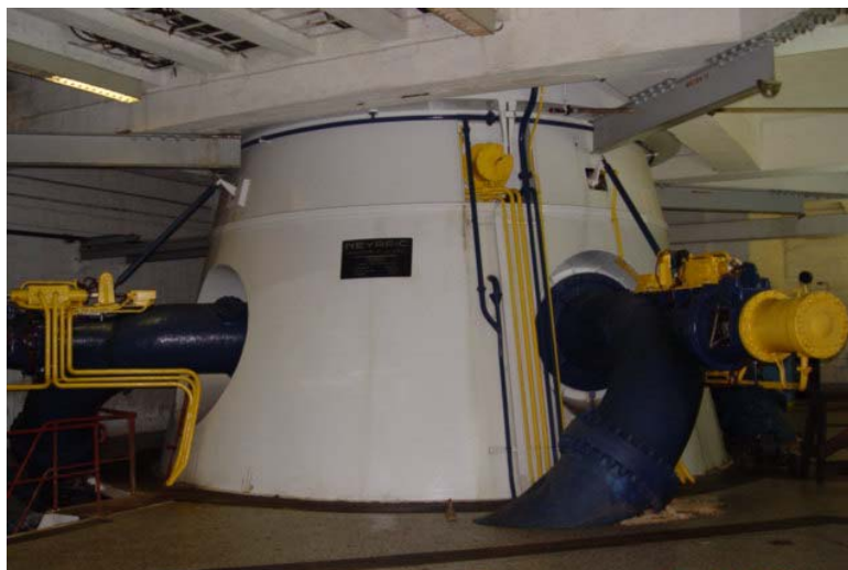
Figure IV-11 Vue bêche turbine et injecteurs
