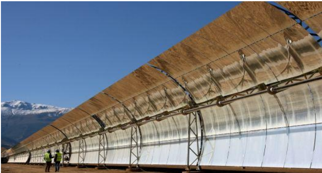
Figure II.3 la plus grande centrale solaire thermique d'Europe en Espagne[13]
