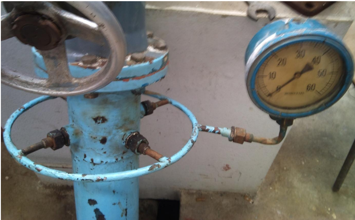
Figure III.9 : Manomètre qui mesure la hauteur effective à l'entrée de la turbine Pelton.
