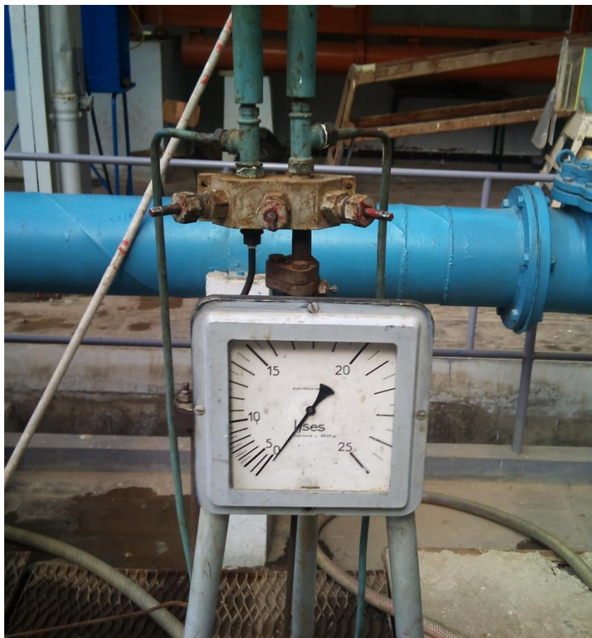
Figure III.1 : La conduite forcée est alimentée, mais l'aiguille ne bouge pas sur le cadran du débitmètre.
