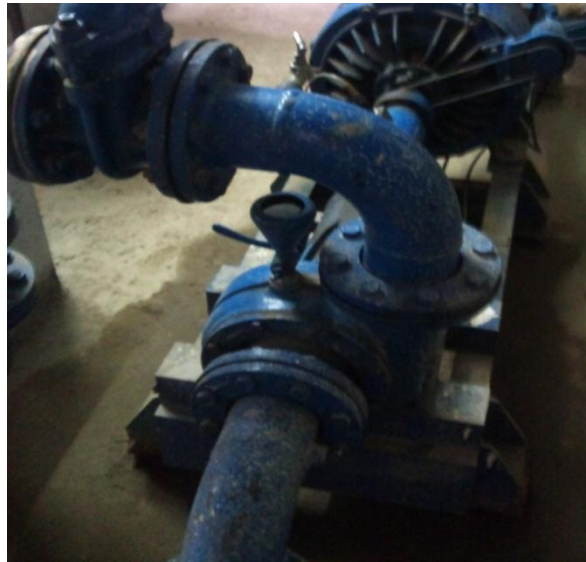
Figure I.6 : Pompe centrifuge du banc d'essai étudié
