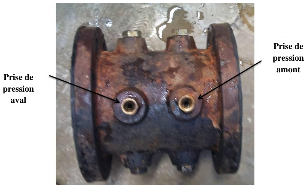
Figure III.7 : Les prises de pression de l'élément déprimogène sont bouchées.
