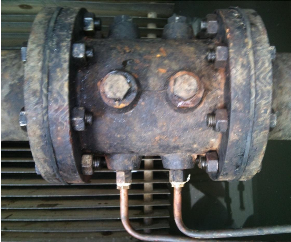
Figure III.5 : Position de l'élément déprimogène avec les sorties des prises de pression avant son démontage.
