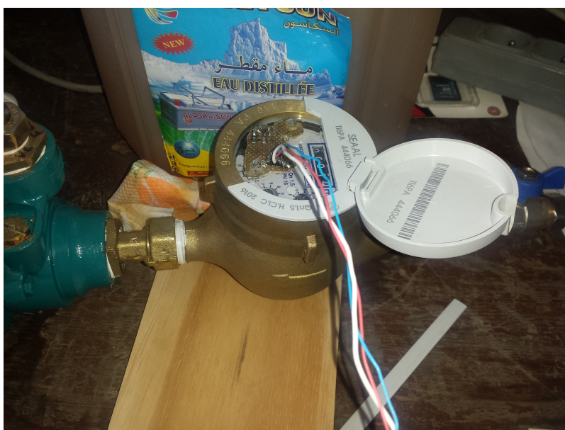
FIGURE 5.17: Montage du capteur sur le compteur.
