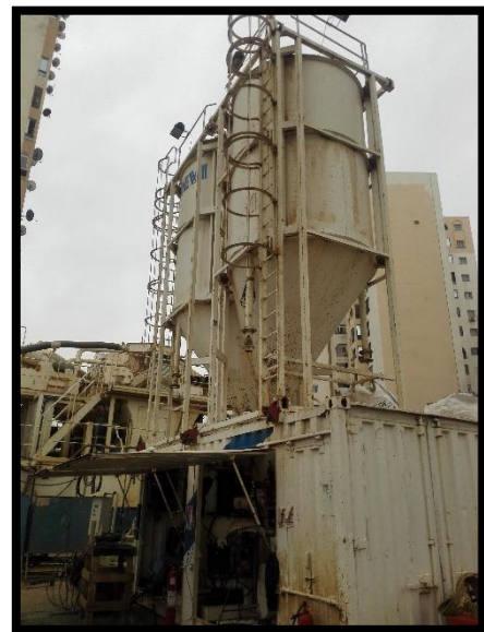
Figure 3-5 : Silos de bentonite en poudre
