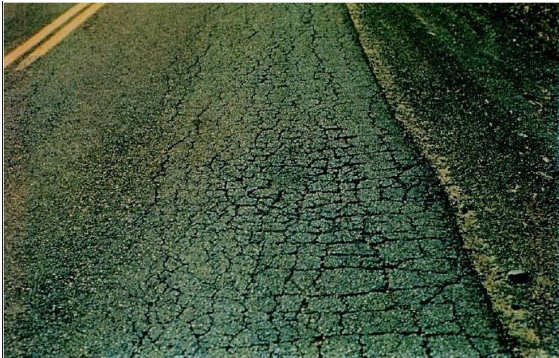
Figure IV.1. Fissuration par fatigue d'une chaussée [25].
