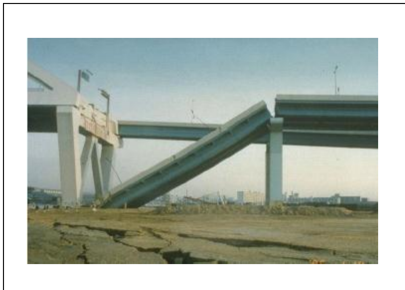
Figure I.4 : Chute du tablier lors du tremblement de terre de Kobe 1995 [3]
