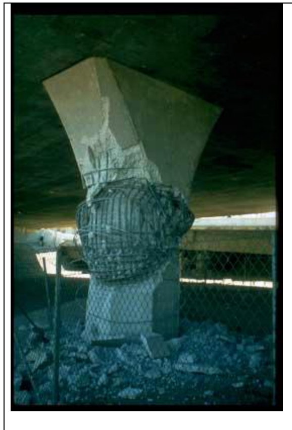
Figure I.7 : Endommagement des piles en béton armé lors du séisme de Northridge 1994 [5]
