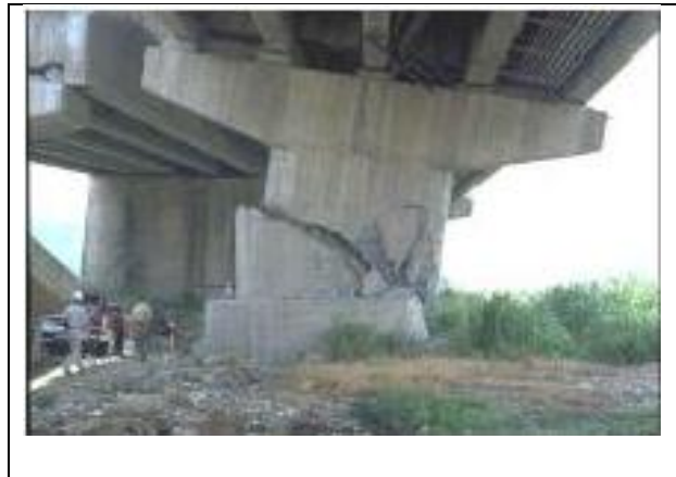
Figure I.8 : Rupture des piles par cisaillement lors du séisme
